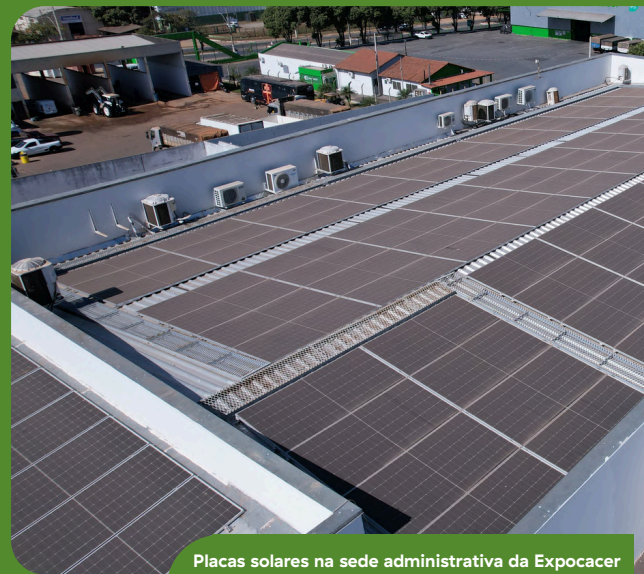
Placas solares na sede administrativa da Expocacer
